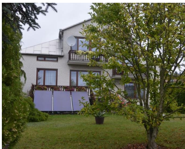
Fot. 18. Instalacje solarne na budynku mieszkalnym.
