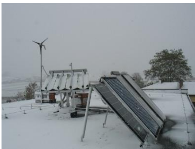
Fot. 17. Instalacje solarne i turbina wiatrowa w Centrum Energii Odnawialnej w Pojałowicach.
