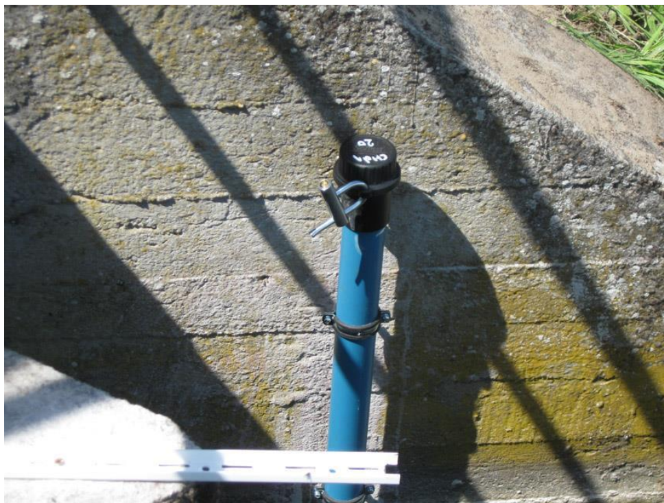
Fot. 16. Rura z tworzywa sztucznego z zainstalowanym czujnikiem poziomu wody w cieku znajdująca się przy budowlu piętrzącej (fot. E. Bolewski)
