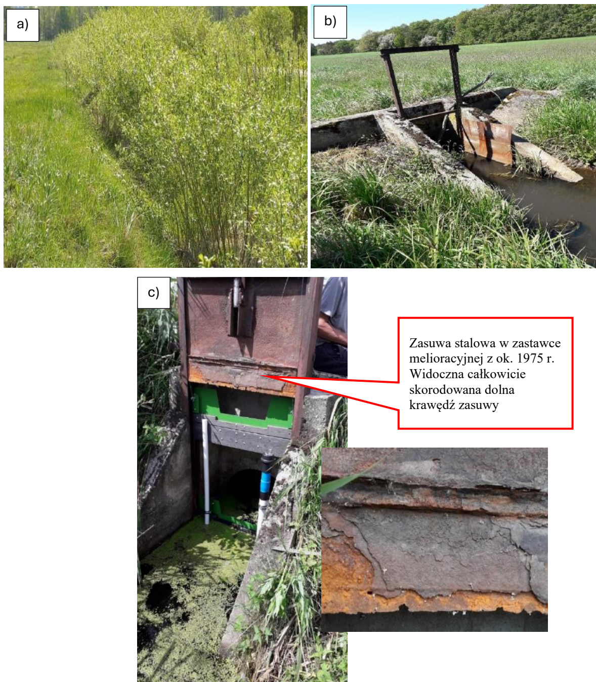
Fot. 14. Przykłady niezdatnych urządzeń melioracyjnych w systemach nawodnień podsiąkowych: a) zakrzaczony rów odwadniająco-nawadniający, b) zastawka ze zniszczonym mechanizmem wyciągowym i zniszczoną zasuwą, c) skorodowana zasuw stalowa (fot. E. Kaca)
