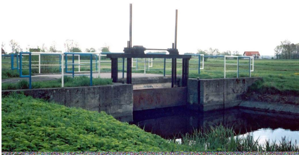
Fot. 13. Jaz na cieku zdalny, ale niesprawny, gdyż nie posiada zaznaczonych znaków (reperów) granicznych piętrzeń wody (fot. L. Łabędzki)
