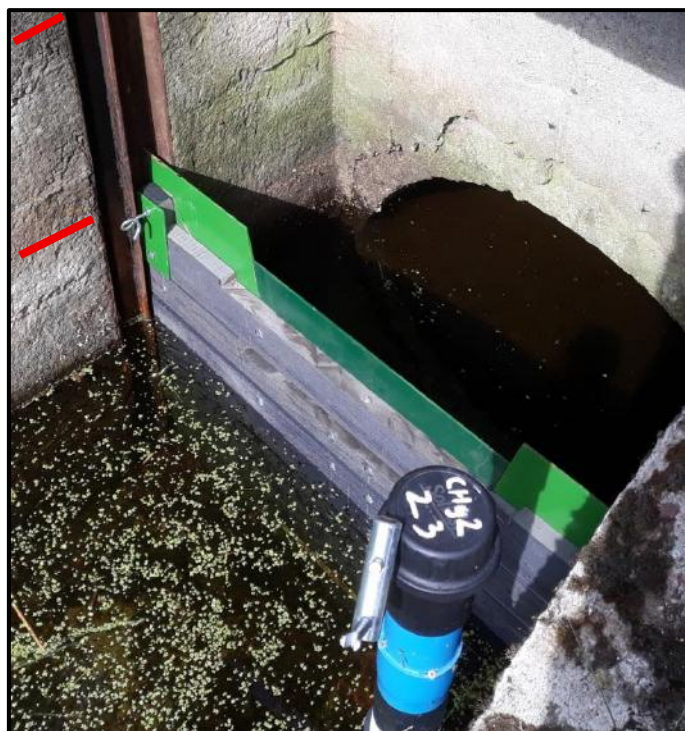
Fot. 10. Zestaw przelewów na przepuszczeniu z piętrzeniem z urządzeniem w studzińce do automatycznego pomiaru stanu wody w górnym stanowisku budowli (fot. B. Kierasiński)
